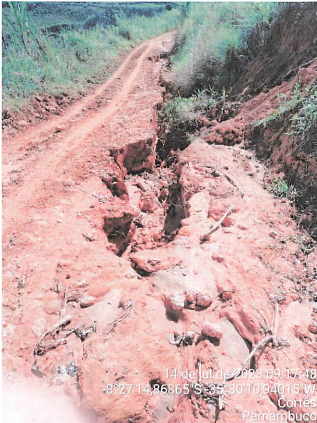
Imagem 01: Erosão na vicinal
