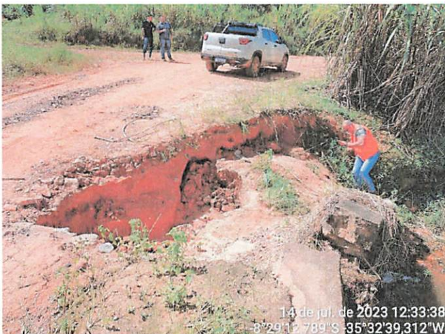
Imagem 03: Erosão e alas do bueiro danificada.
